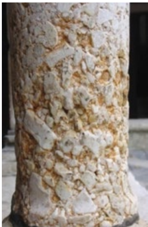
Fig. 2 - Particolare di degrado materico.
