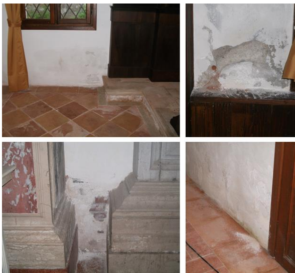
Fig. 12 – Esempi di degrado delle superfici
