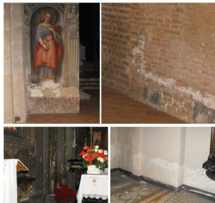
Fig.6 – Esempi di degrado delle superfici
